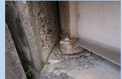
支承部機能障害
