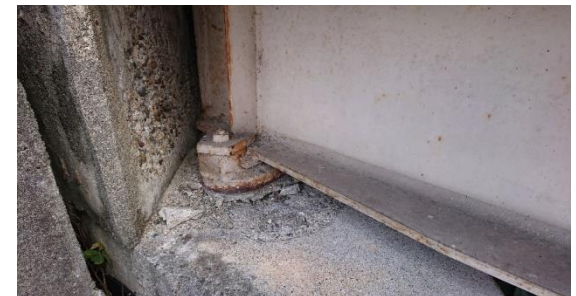
支承部機能障害
