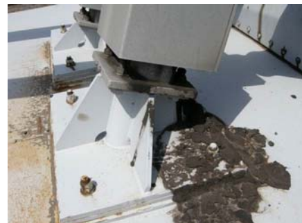
制振ダンパーの粘性体漏れ
