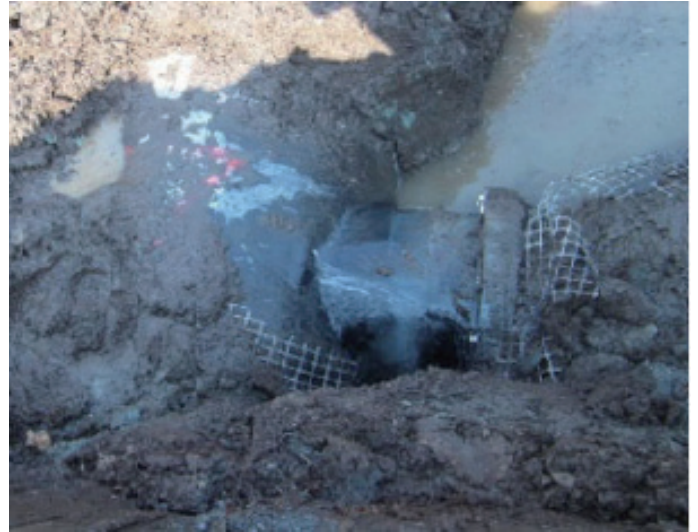
写真 管水路の漏水破損事例
