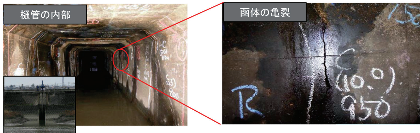
樋管の亀裂の事例。樋管函体内に亀裂や錆混じりの漏水が生じています。鉄筋の腐食によるコンクリートの剥離など断面欠損によって函体の健全度が失われる可能性が高く、適切な措置を要します。
