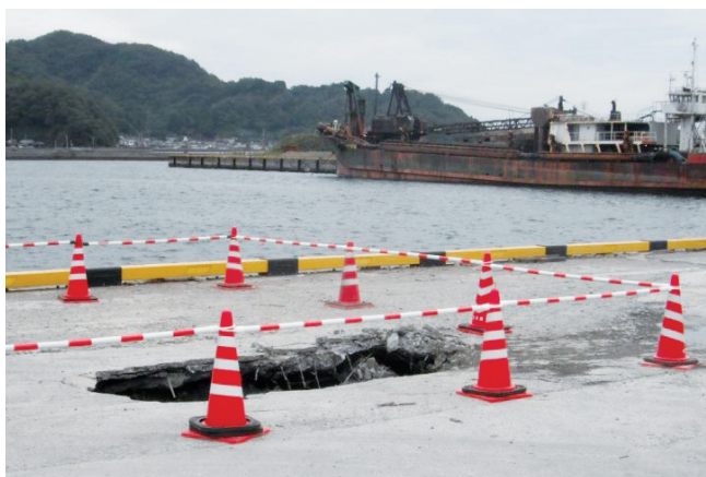
岸壁の陥没（エプロン部）
