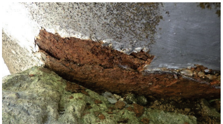
水圧鉄管 塗装劣化状況
