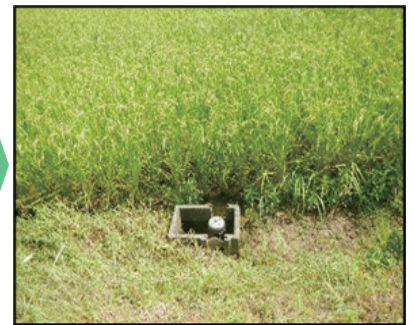
写真 水田に農業用水を給水する水田パイプライン末端バルブ
