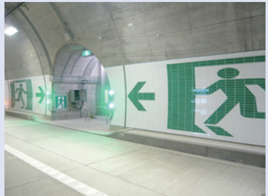
写真 非常口を強調表示した例
