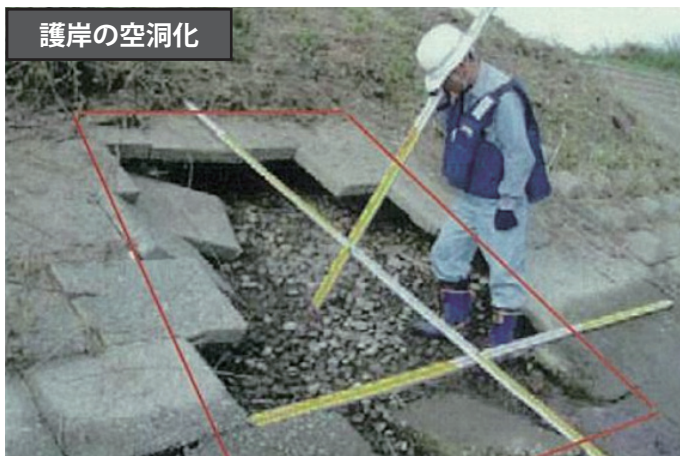
護岸が部分的に流出し、護岸背面の土砂が吸い出され、空洞化が進んでいる様子です。護岸の機能が失われており、適切な措置を要します。
