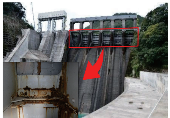
常用洪水吐（クレストゲート）の老朽化による鋼材の腐食状況の事例。このままでは腐食が進行し、構造物の機能に支障が生じる可能性があるため、早期に措置をすることが望まれます。
