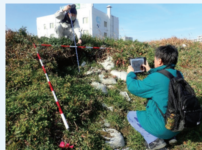
堤防の点検状況。洪水から地域が守られるよう定期的な点検・評価によって、河川管理施設の状況を確認。
