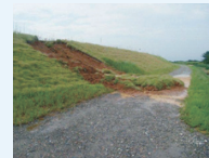
雨水の堤防への浸透に起因して法崩れが発生した様子。堤防機能に支障が生じており、直ちに措置を要します。
