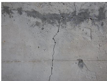
図 5.2.1 ひび割れの例
