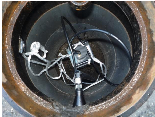
図 3.3.2 マンホールに設置された漏水センサ
