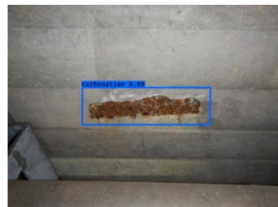
図 5.2.10 鉄筋露出の検出例 (YOLO v3)
