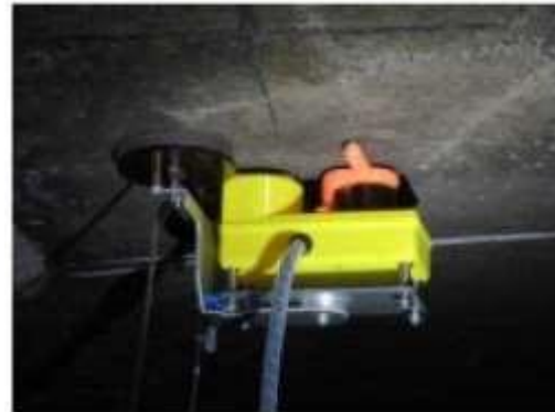
図 4.2.8 版型音響取得機設置状況
