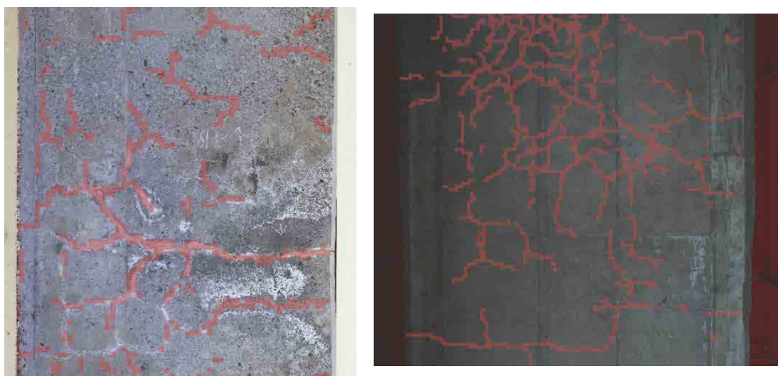
図 2.2.4 ひび割れのアノテーション実例 (Chubu-6-2 と Hokuriku-3-2)
