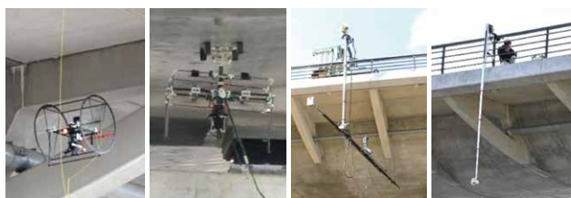
図-4 SIPインフラで開発されたUAV・ロボット(資料:インフラ維持管理・更新・マネジメント成果事例集(JST/岐阜大学))
