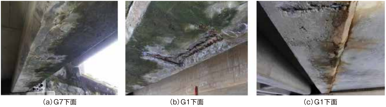
図-2 主桁下面の損傷状況
