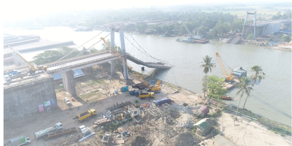
落橋事故とその後の対応
