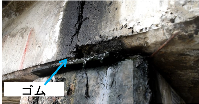
支承の劣化・桁と梁が密着
