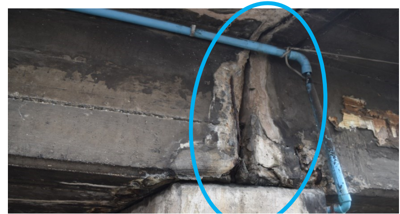
水みち(漏水跡)
