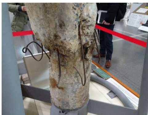
写真⑥-1 破壊した PC 杭
