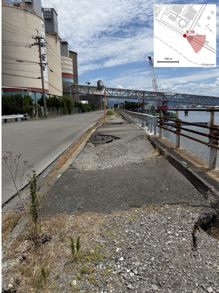
9 八代港南西側護岸. 歩道部の舗装が一部陥没. 一部護岸が海側にせり出している.
