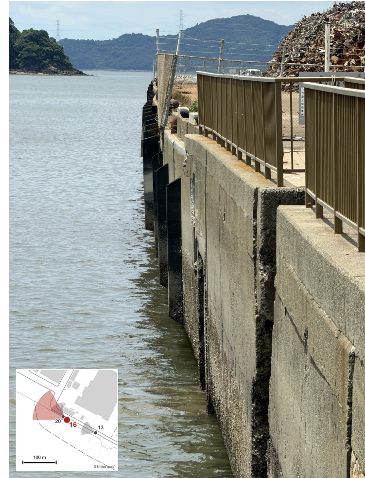
16 八代港南西側。護岸の海側へのせり出し状況。
