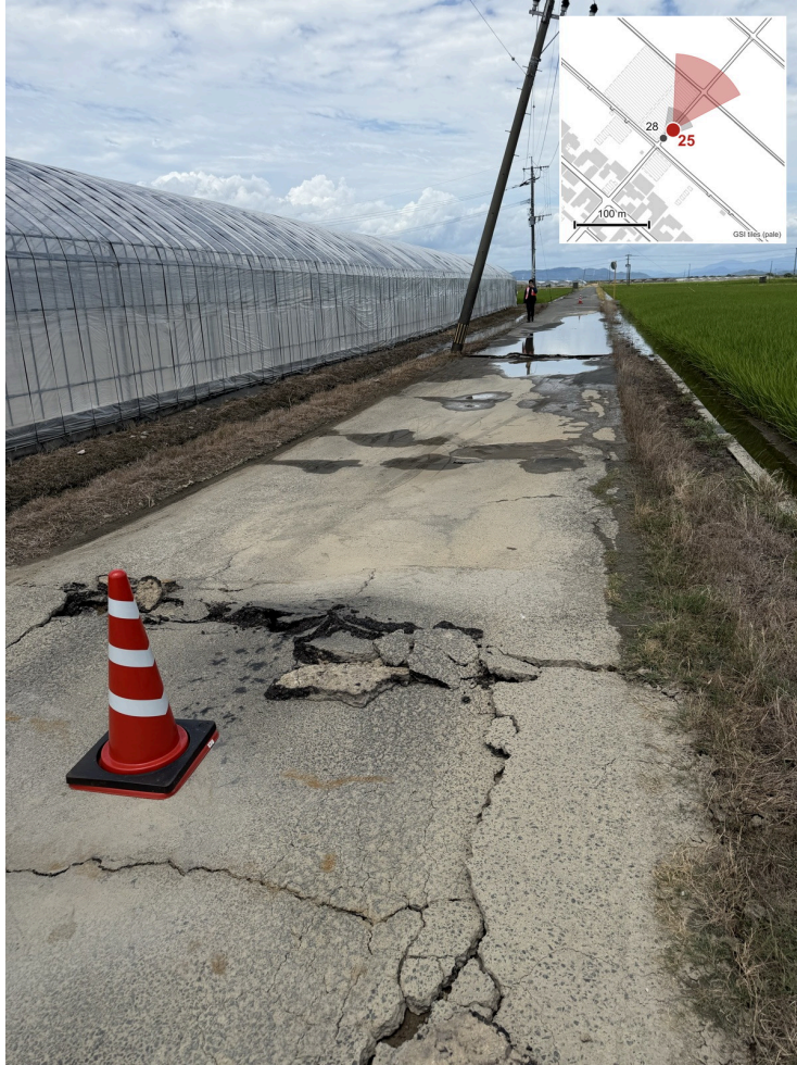
25 八代市鏡町北新地内での液状化。ビニールハウス横に噴砂を確認。
