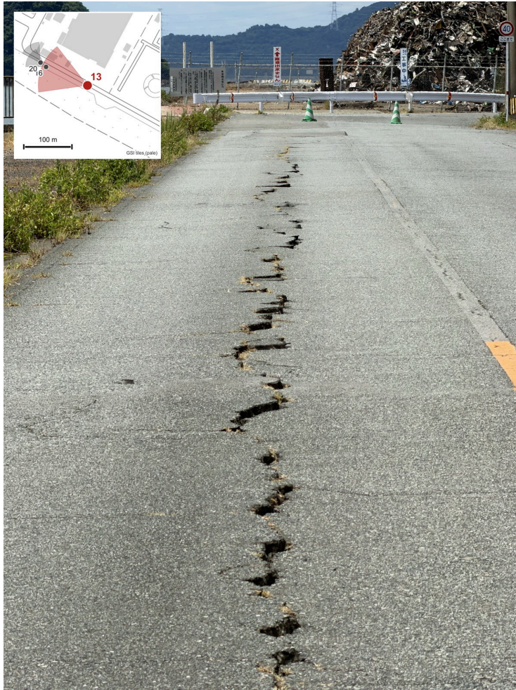
13 八代港南西側。左側が海。ほぼ護岸と平行に道路舗装上に亀裂。
