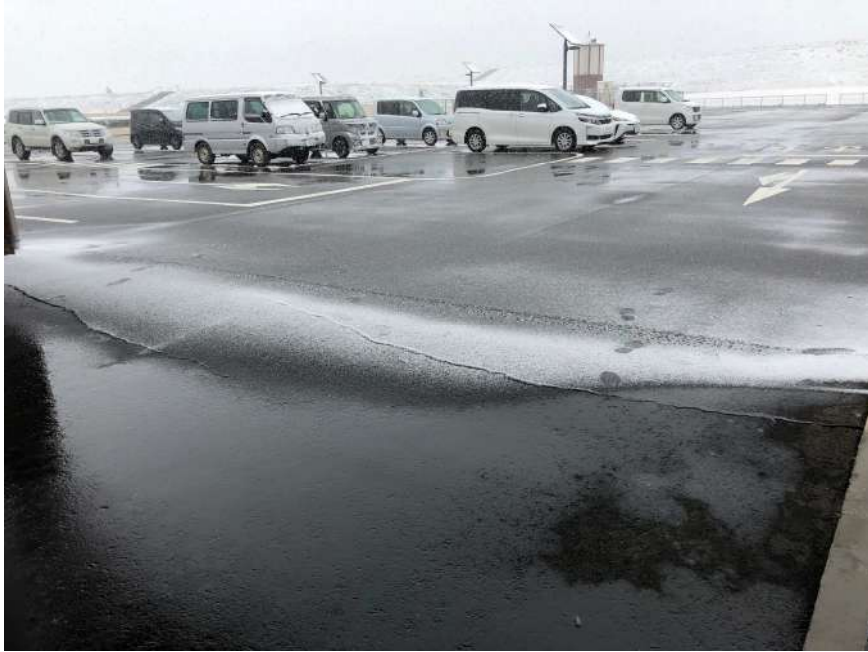
わたり温泉鳥の海 玄関前→舗装亀裂
