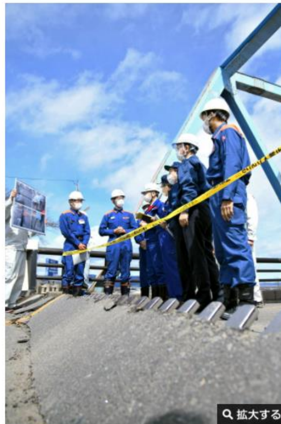
齊藤国交相(左から3人目)に399号国道・伊達橋の被災状況を説明する内堀知事(同2人目)。橋が東西方向に約40センチずれて接合部の路面(手前)が盛り上がり、全面通行止めになっている=19日正午ごろ、伊達市前川原
