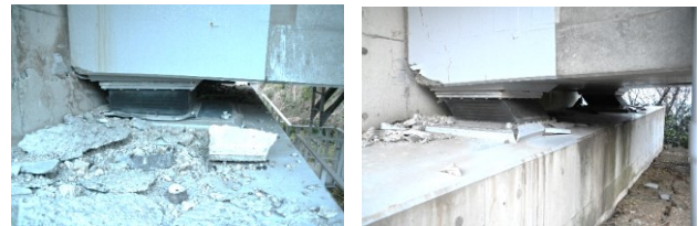
(d) Failure of attachments of rubber bearings
