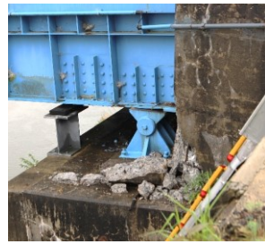
(d) Damage to bridge abutment
