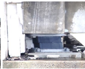
(d) Rupture of rubber bearing
