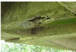
鉄筋の露出(桁)
