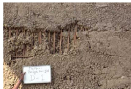
鉄筋の露出(橋脚)
