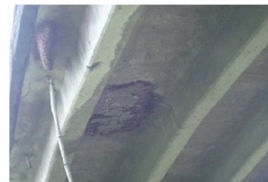
コンクリートの剥離(桁)
