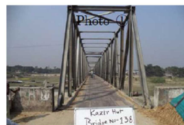
幅員の不足(国道上のペイリー橋)
