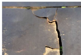
鋼床版の損傷
