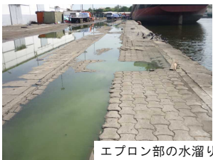
エプロン部の水溜り
