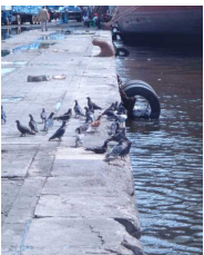
欠損したコンクリートブロック
