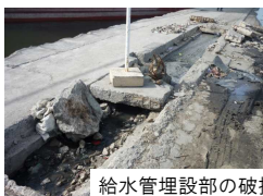
給水管理設部の破損
